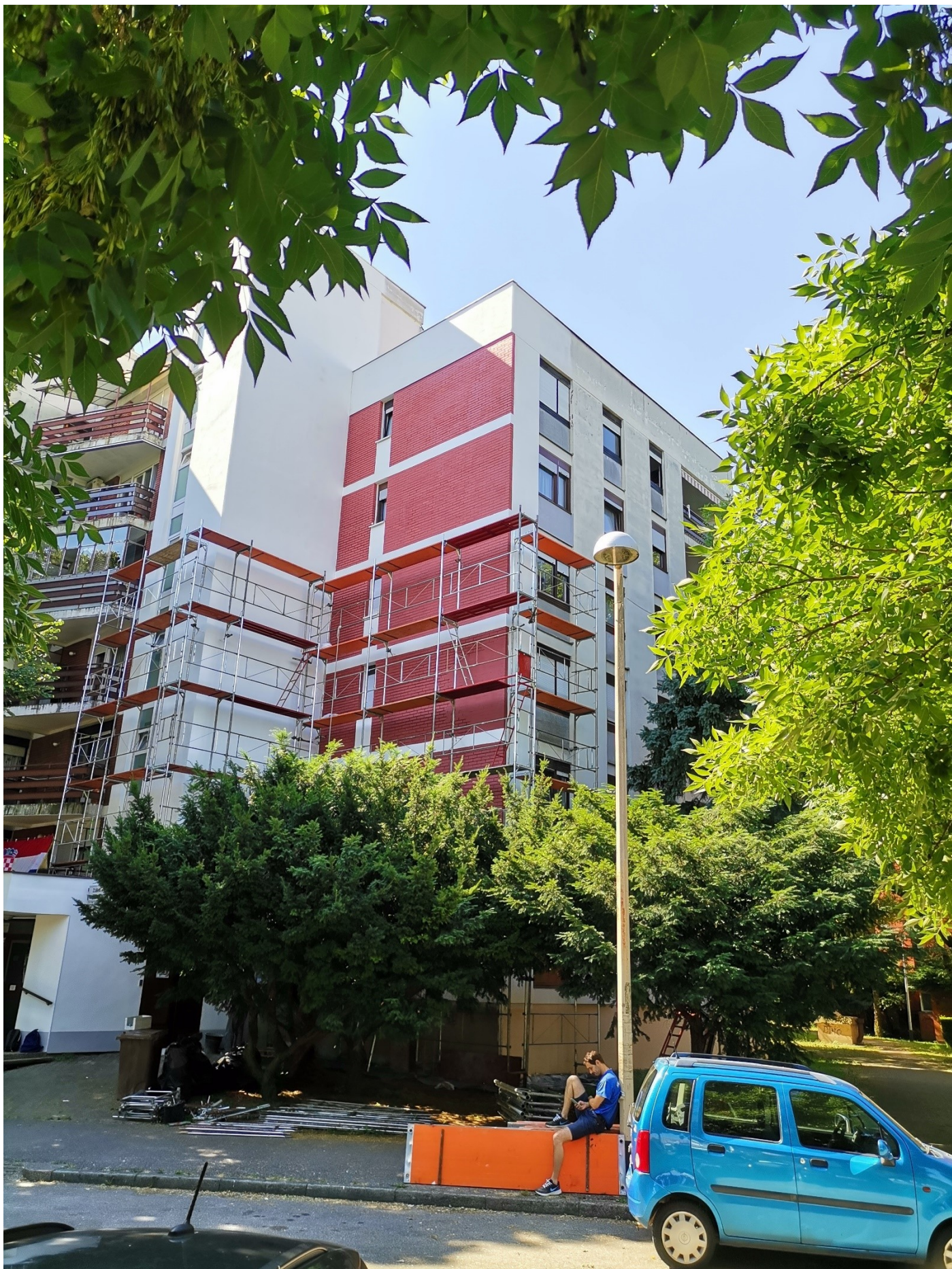
Bolšičeve 1 i 15 Zagreb fasada je samo djelomično termo-izolirana Bronya tj. nisu obuhvaćene sve strane
