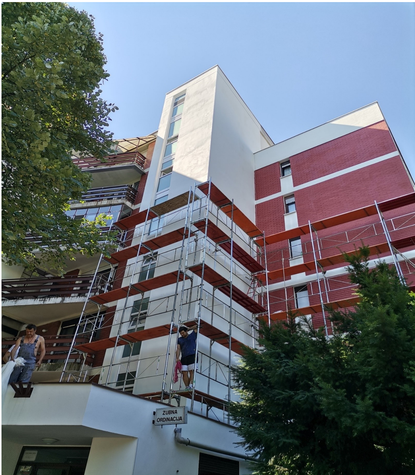
Bolšičeve 1 i 15 Zagreb fasada je samo djelomično termo-izolirana Bronya tj. nisu obuhvaćene sve strane
